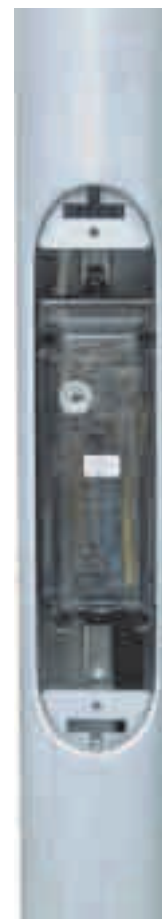
Вводный щиток в нише алюминиевой опоры
